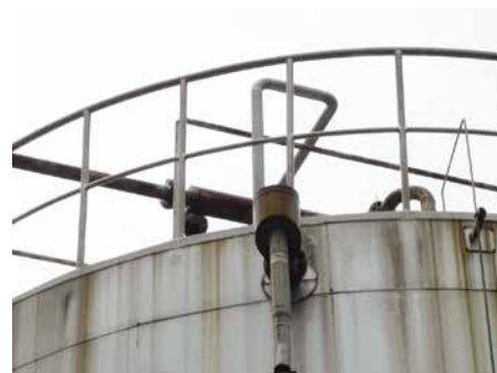
石油タンク用消火設備
